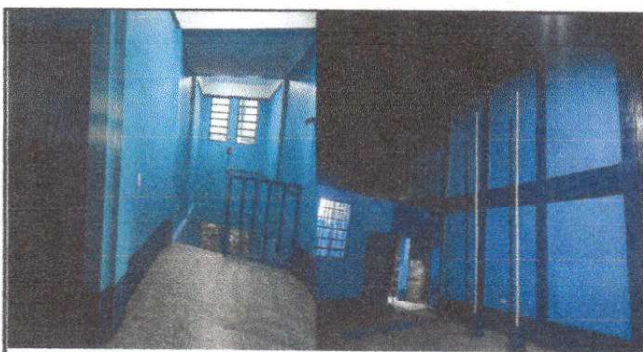
Foto 3: Pintura en muros interiores (imagen lado izquierdo) y exteriores (imagen lado derecho) de toda la escuela.
